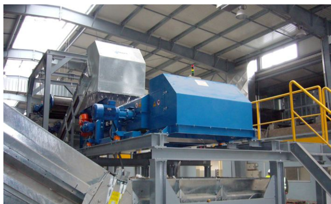
Oczyszczanie tworzyw sztucznych z metali nieżelaznych.
