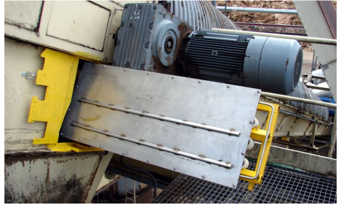
Płyta magnetyczna zamocowana na konstrukcji jezdnej, wysuwana ze zsypu zrębków drzewnych.
