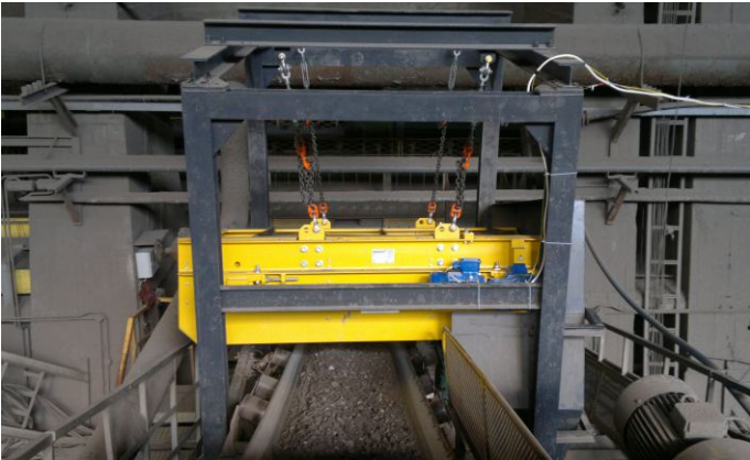
Usuwanie zanieczyszczeń żelaznych z rudy miedzi.
