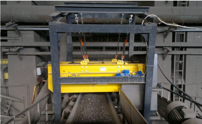
Usuwanie zanieczyszczeń żelaznych z rudy miedzi.
